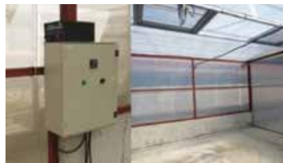
Figura 17. Cámara térmica con sistema automatizado para termoterapia de semilla de yuca.
