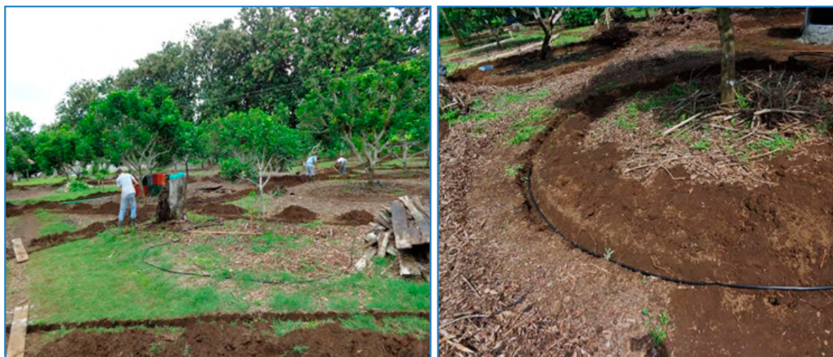
Figura 24. Equipo e instalación de los sistemas de riego. San Buenaventura de Osa. 2016-2020.
