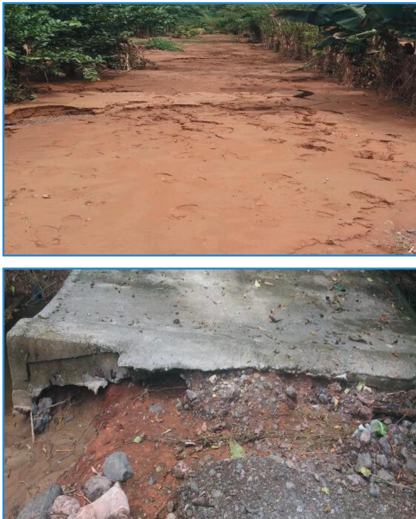
Figura 138. Daños causados por la Tormenta Nate, nivel de las aguas dentro del Campo Experimental y daños en puente interno, Quepos, 2017.
